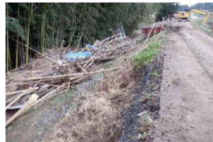
写真6 戻り水による被害
