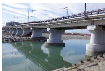
写真 3 日野橋の洗掘被害
