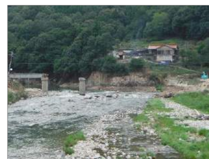
写真7 白木の橋脚被害
