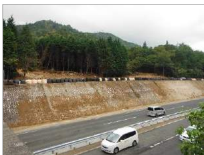
写真4 高野の道路被害
