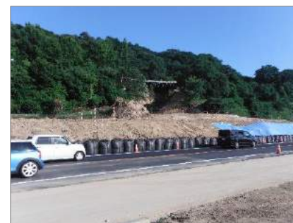
写真6 水尻の盛土被害
