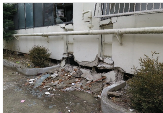
図-3 建物基礎部の被害状況
