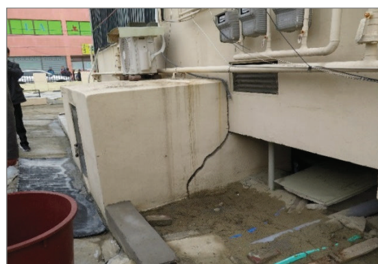
図-2 約1.2m噴砂した建物基礎の被害
