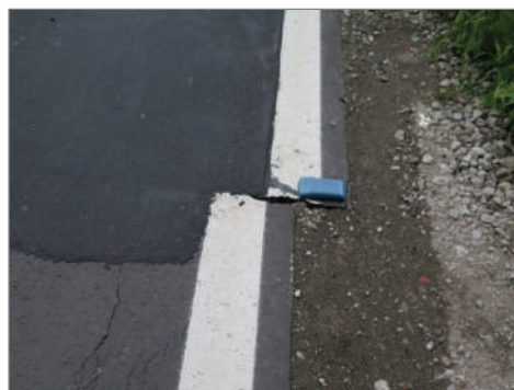
図-3(a) 10号道路のずれ
