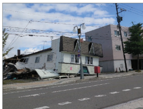
図-1 むかわ町での建屋の被害
