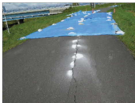
図-2 鵒川堤防の被害ブルーシート
