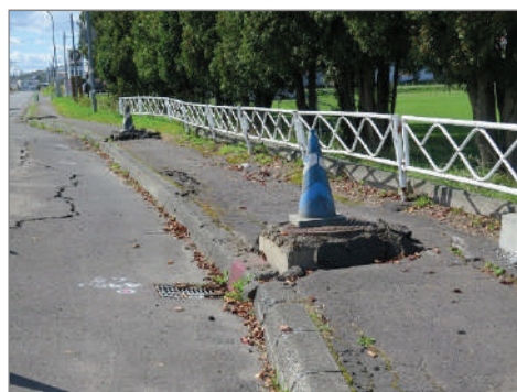
図-4 安平町での水道の被害状況
