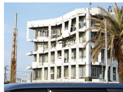
写真-1 宇土市役所被害
