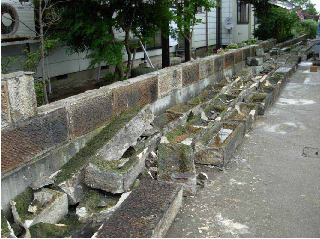
写真 622 塀(凝灰岩、鉄筋無し)の崩壊 (市街地)
