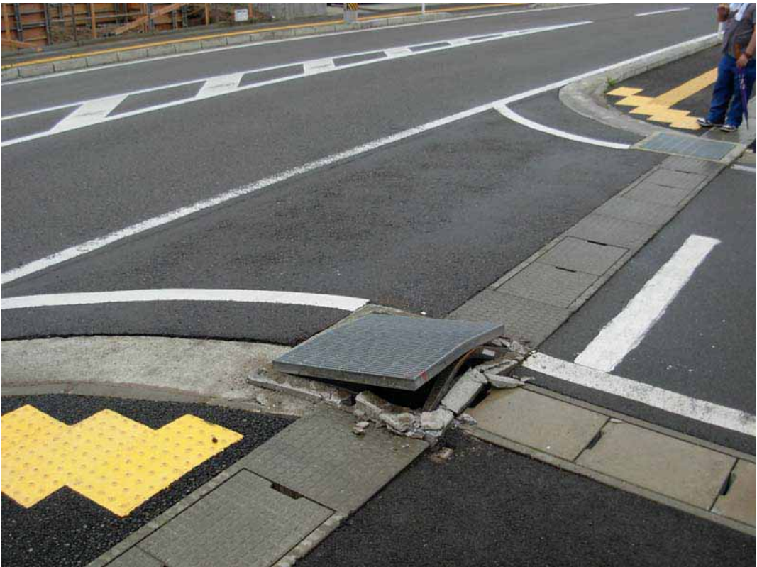
写真 631 側溝の破壊 (市街地) 周囲からの圧縮による破壊
