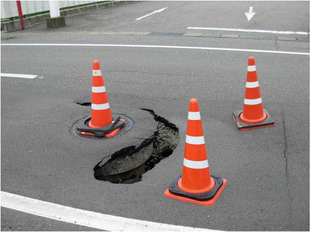
写真 611 マンホール浮き上がり（市街地）
