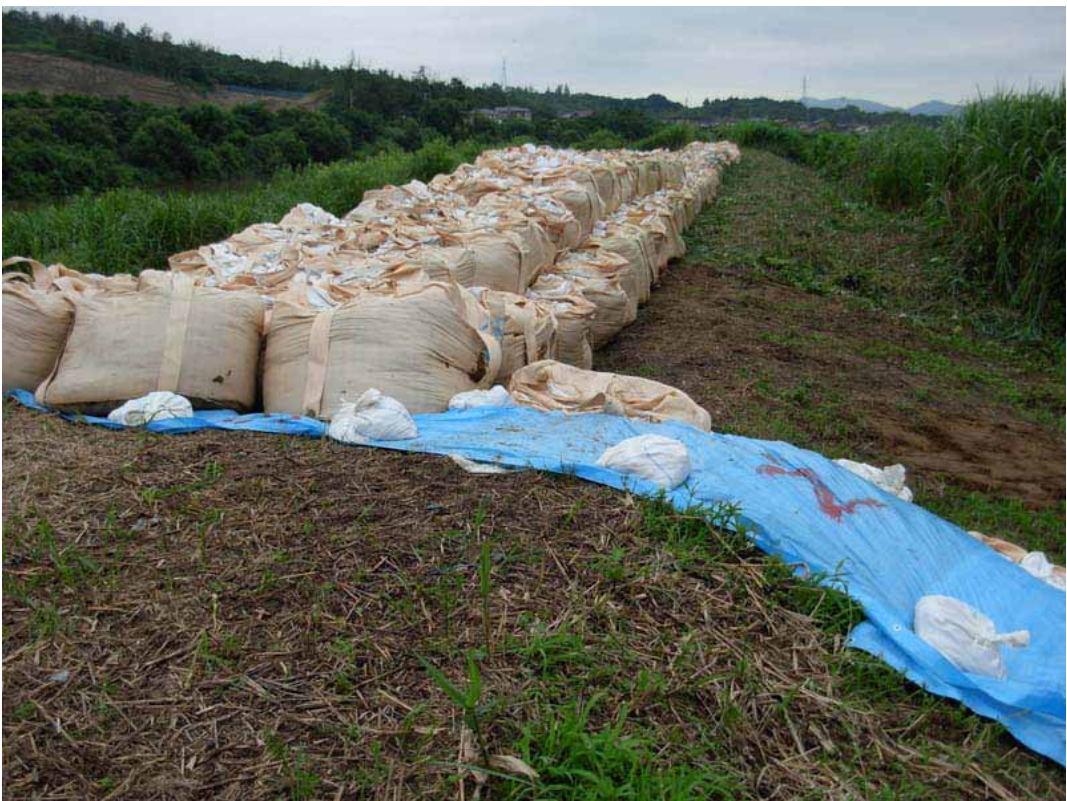
写真 763 堤防の沈下（最大 1m 程度）
