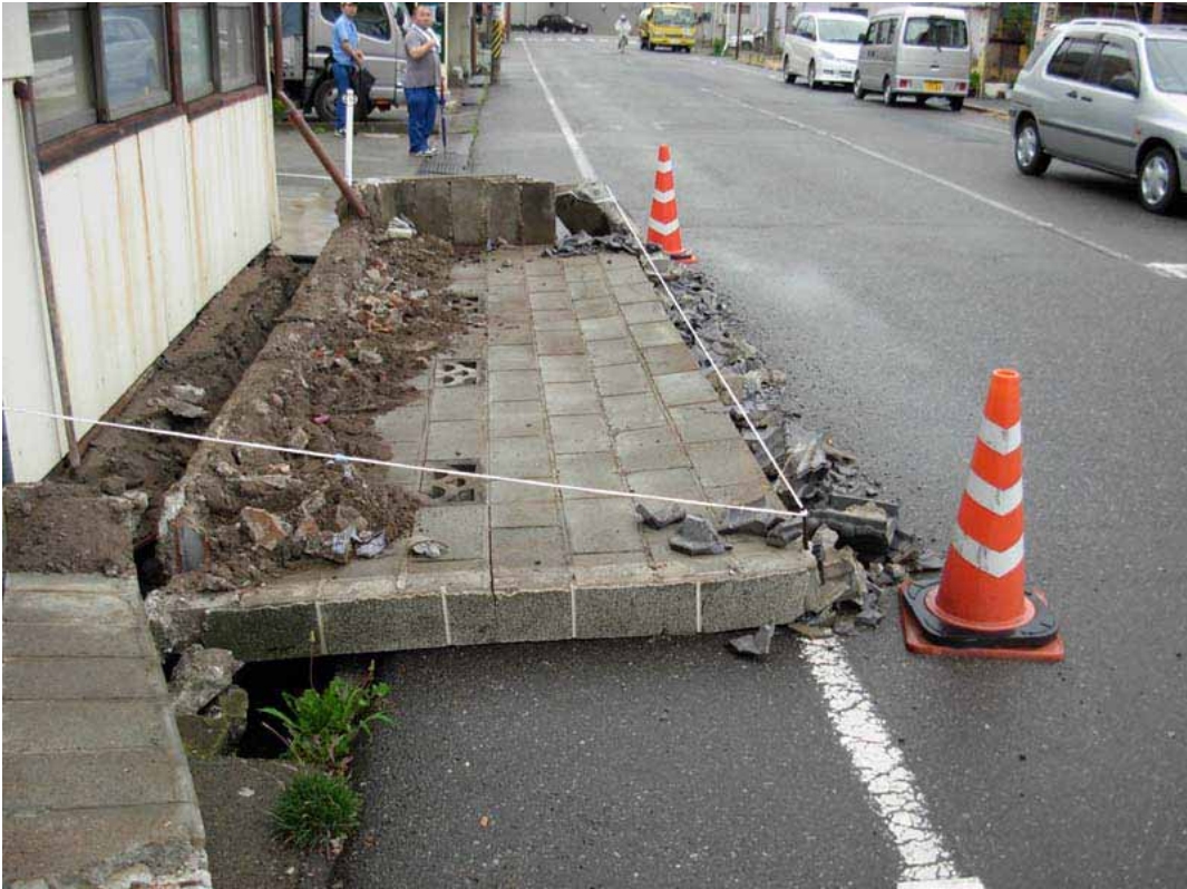
写真 639 ブロック塀根元からの転倒（市街地） 鉄筋が入っているのかは不明。基礎から倒れる事例
