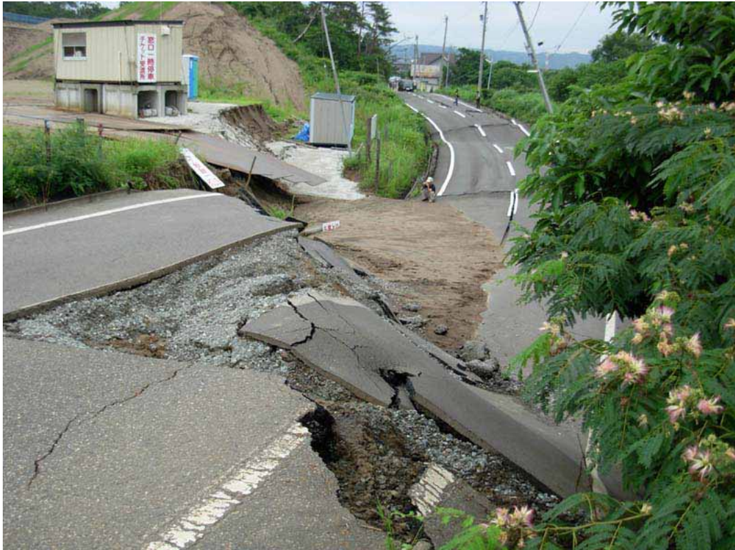
写真 752 焼却場までの道路（沈下最大 3m 程度）
