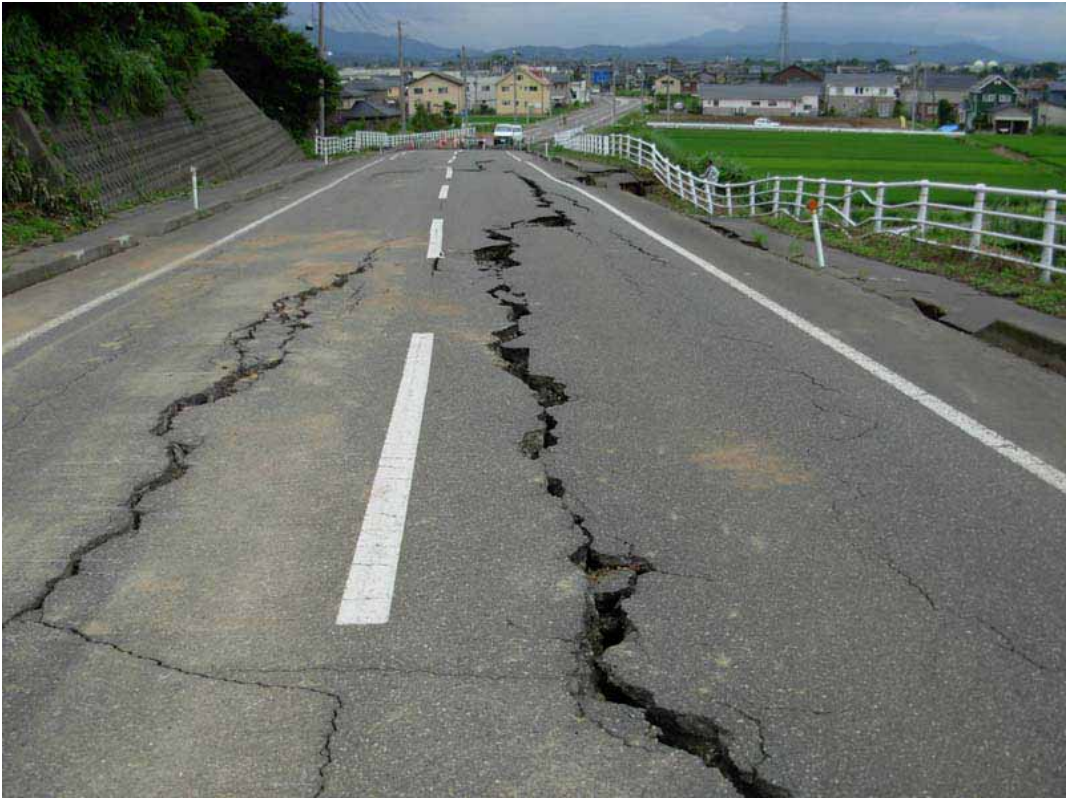
写真 725 西中通駅付近の道路 右の田んぼ側に沈下
