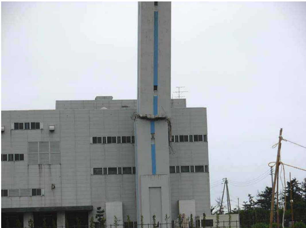
写真 750 焼却場煙突の破壊部分
