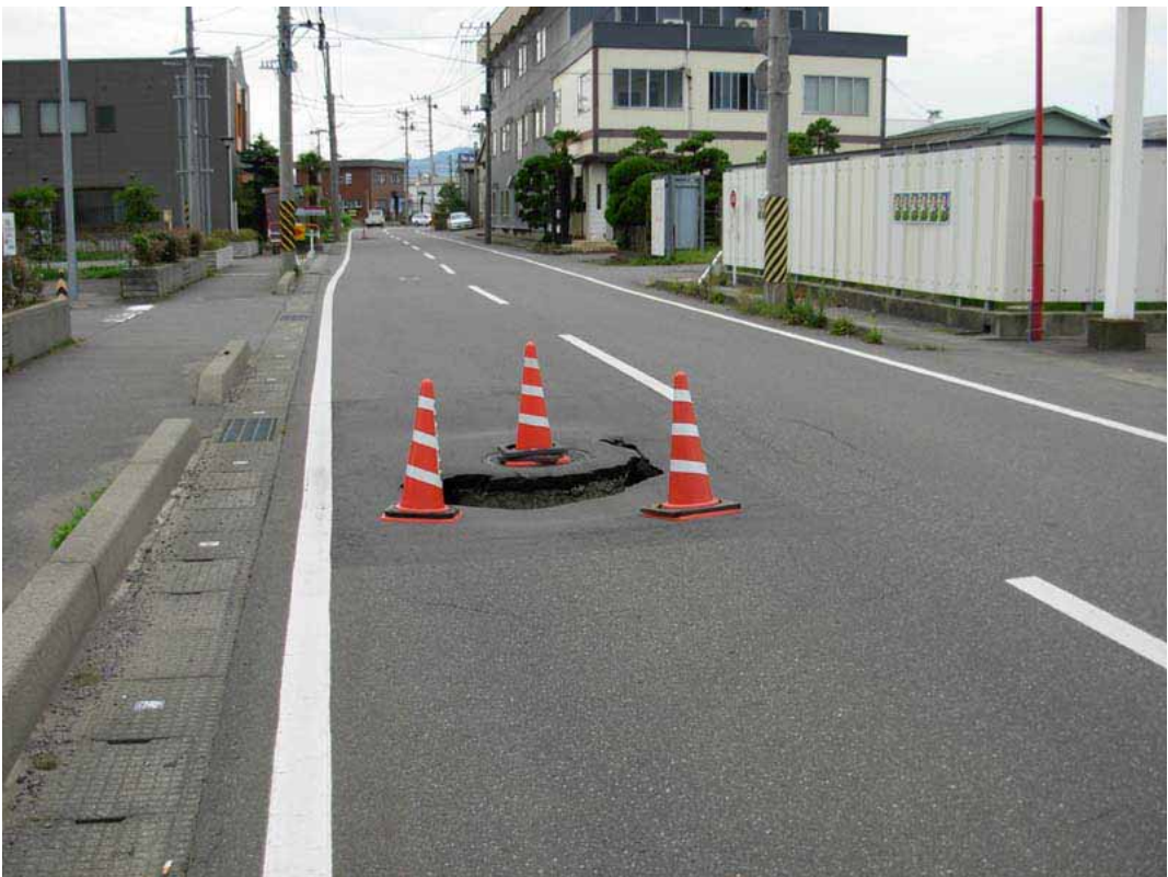
写真 612 マンホール浮き上がり（市街地）
