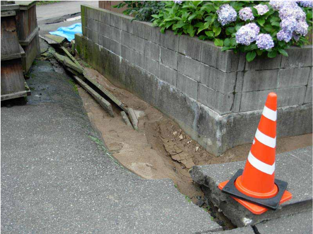
写真 753 液状化による噴砂
