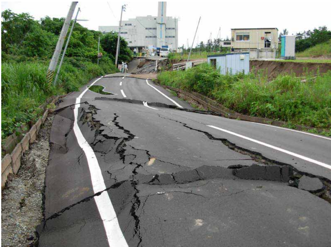
写真 748 焼却場までの道路（沈下） 南側の川に沈下
