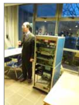
データセンター見学 (その2)
